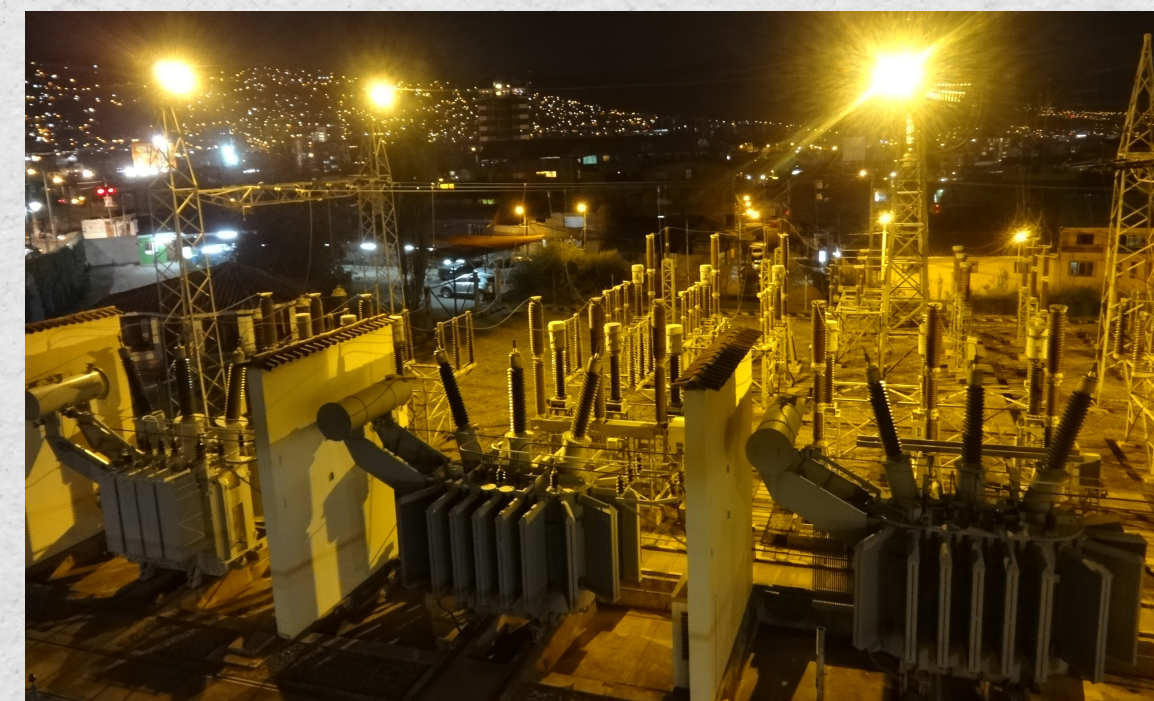
Subestación Dolorespata 138 /10.5 KV alimentación parte norte, y centro de la ciudad del Cusco.
