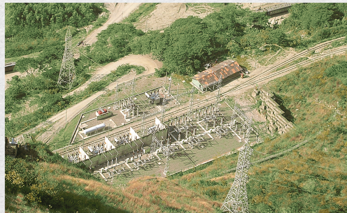
Subestación Central Hidroeléctrica Machupicchu 13.8/138 KV km 122.
