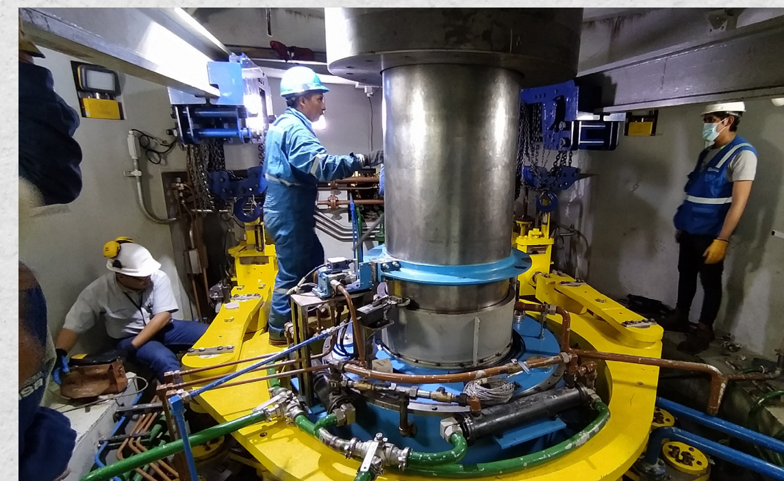
Montaje de Instrumentación de Turbina Grupo Francis. Ubicado en Casa de Máquinas Grupo Francis (Recinto de Turbina).
