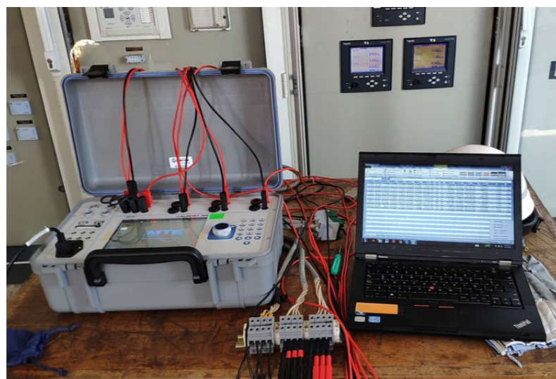
Contratación de medidores de clientes de Egemsa
