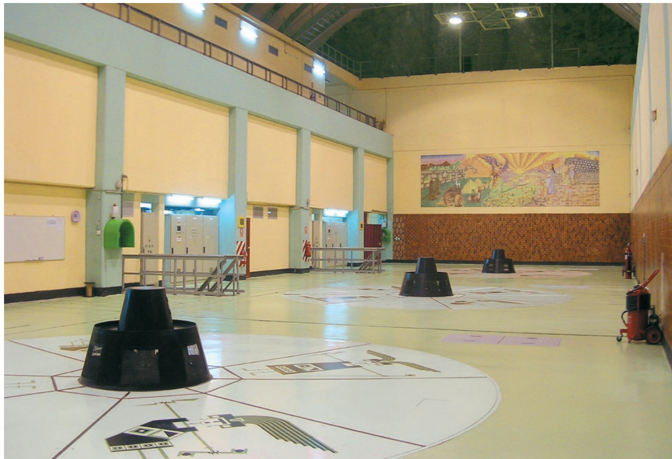
Casa de máquinas grupos pelton CHM.
