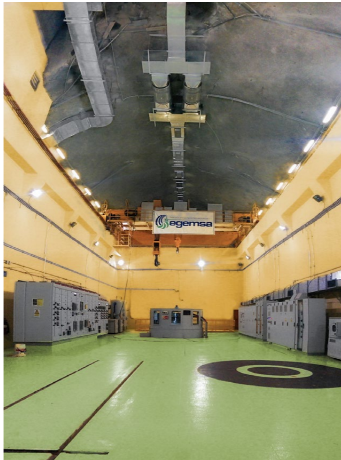
Casa de máquinas grupos francis CHM.
